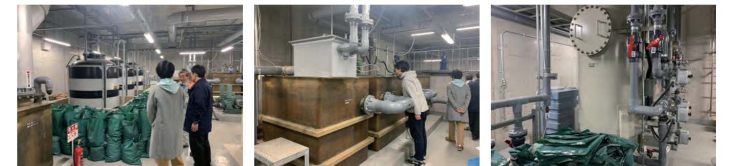
理系学舎地下の排水処理設備の様子
